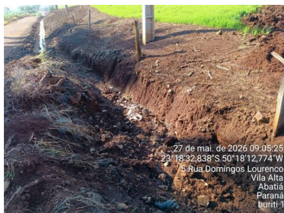
Figura 07 – Escoamento restrito à área imediata
