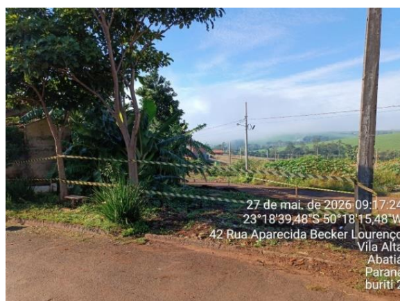
Figura 12 – Área do Buriti II com necessidade de adequação do isolamento
