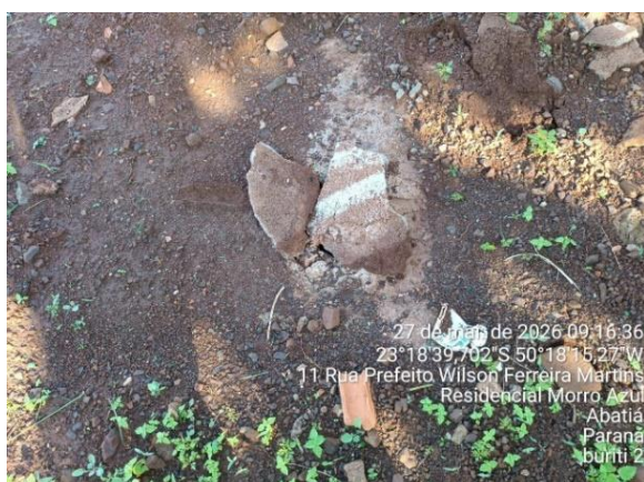
Figura 11 – Detalhe de tampa parcialmente quebrada no Buriti II
