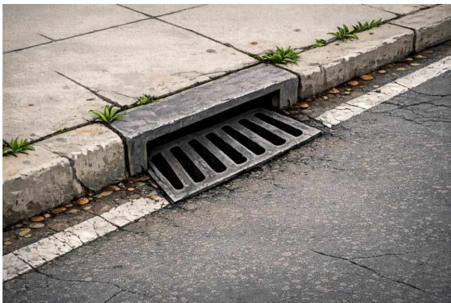
Figura 02 – Boca de lobo
