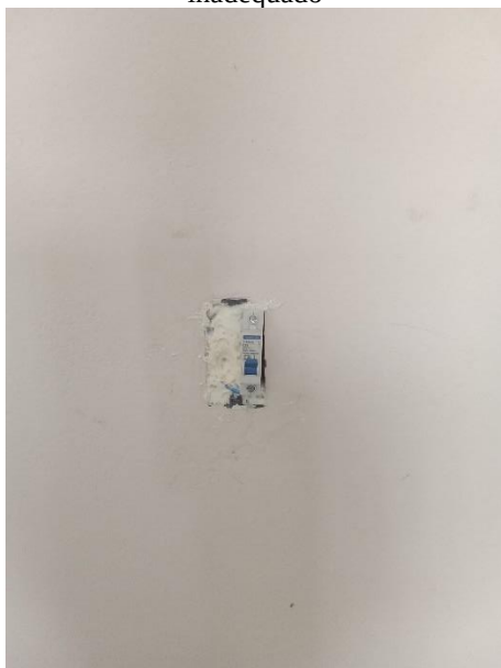
Imagem 5 – Instalação elétrica em local inadequado
