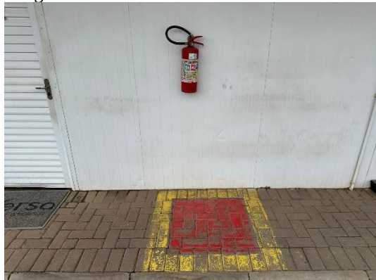
Imagem 24 – Extintor de incêndio
