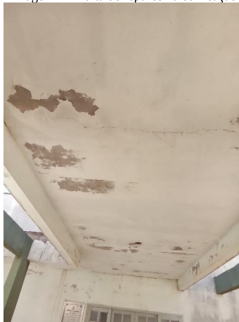
Imagem 4 – Falta de reparos na edificação
