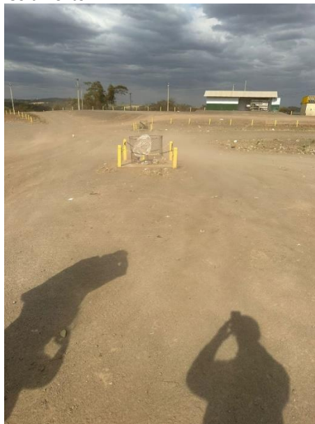
Imagem 27 – Ponto de captação de gás com isolamento
