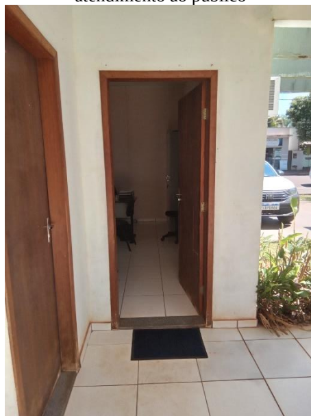
Imagem 2 – Falta de identificação ao local de atendimento ao público
