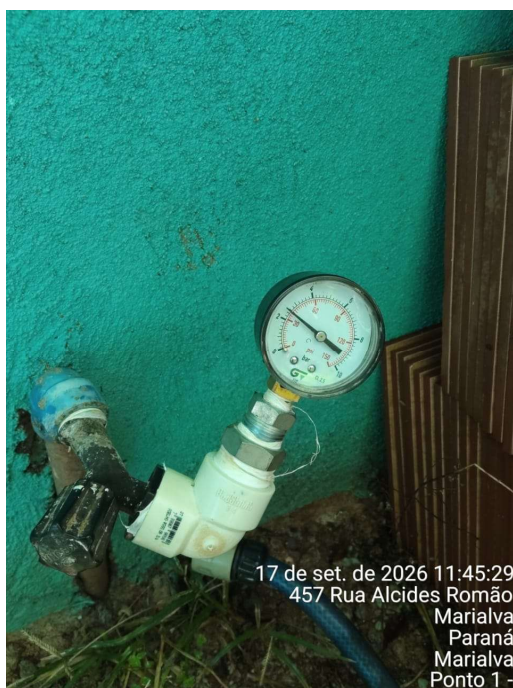
Foto 1 – Ponto de verificação da pressão no sistema de abastecimento de água, no endereço objeto do protocolo de Ouvidoria.
