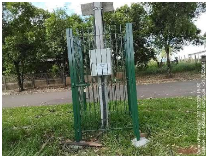
não possui casa de comando
