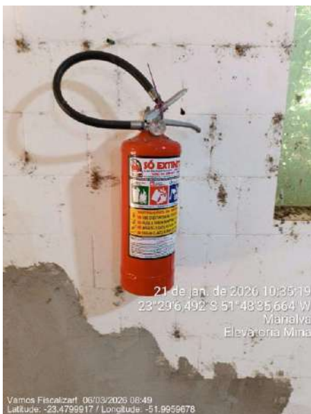
O extintor fica na sala da elevatória.
